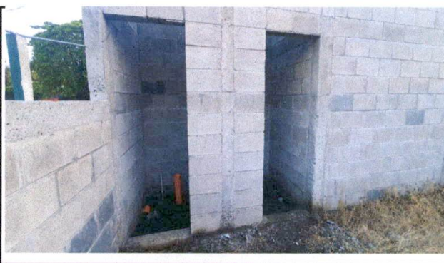
Foto 12: Servicios sanitario inconclusos
