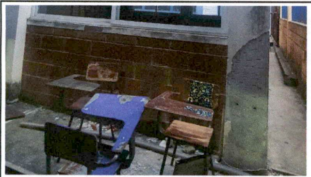
Foto 3: Repello en mal estado
