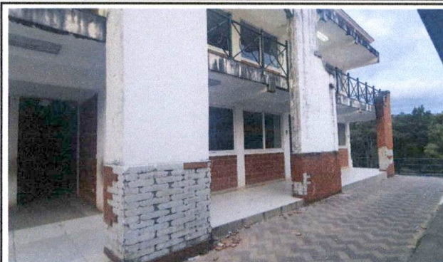
Foto 8: Areas con fachaleta en mal estado
