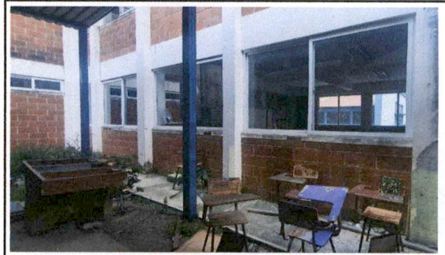
Foto 2: Muros con falta de mantenimiento
